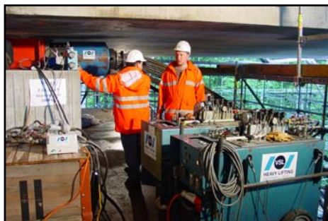
▲ Řídicí jednotka a tažné lanové lisy.
