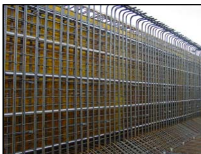
▲ Primární kabely vedené i ve stěnách.
