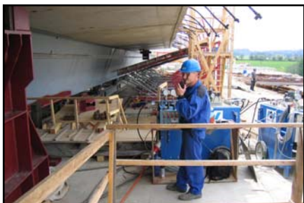
▲ Tažný kabel, řídicí jednotka výsuvu.
