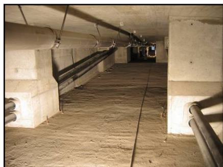
▲ Průběh externích kabelů v komoře.
