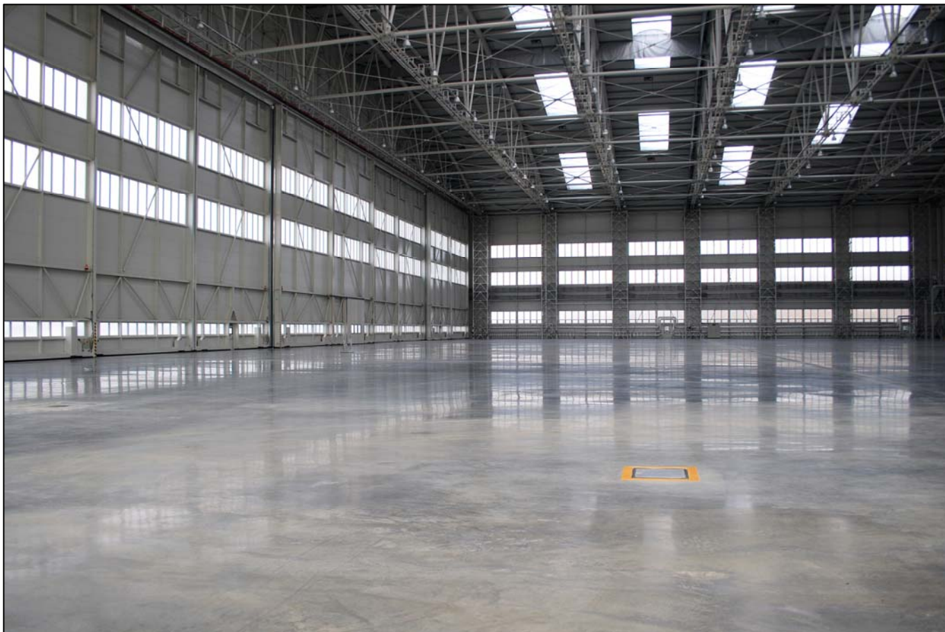
▲ 11 250m 2 homogenní podlahové desky bez trhlin.
