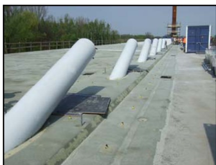
▲ Ocelové průchodky v mezidesce
